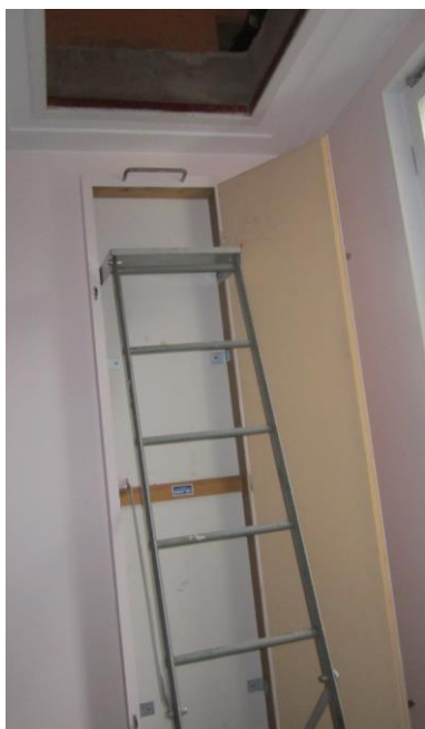
Figur 2: Befintlig stege som går till ett av de sex stycken tilluftaggregaten
