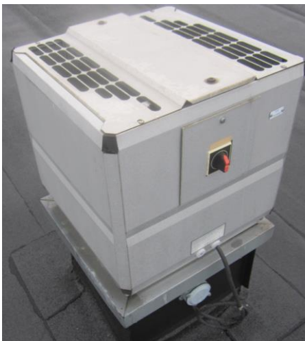
Figur 8: Frånluftfläkt på tak
