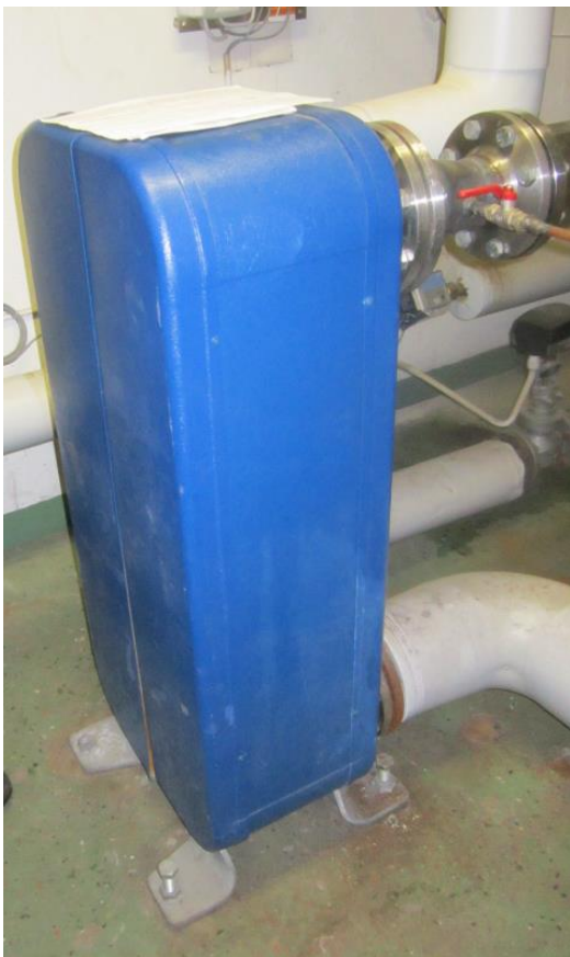
Figur 9: Befintlig fjärrvärmväxlare värme
