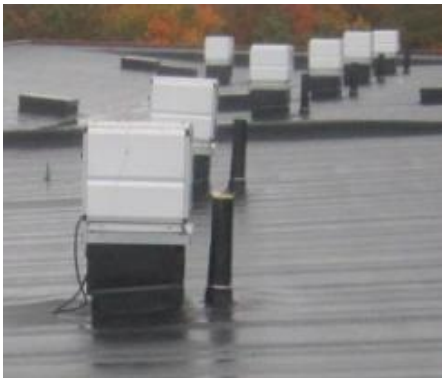
Figur 7: Frånluftfläktar på tak
