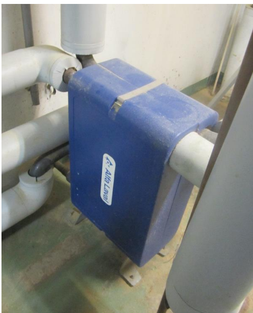
Figur 10: Befintlig fjärrvärmväxlare varmvatten
