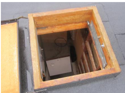
Figur 6: Lucka på tak för att komma åt frånluftfläktarna på taket
