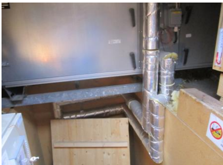
Figur 4: Utrymme där tilluftaggregat sitter
